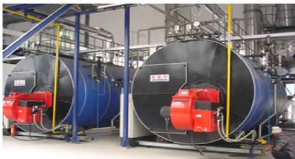
Hệ thống lò hơi trong nhà máy Sữa
