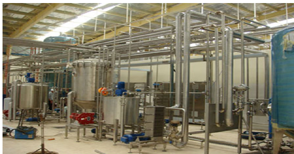
Các hệ thống gia nhiệt trong nhà máy Bia
