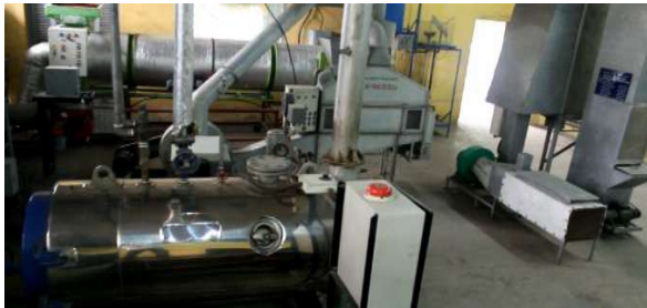
Một góc Xưởng Nhiệt – Điện lạnh
